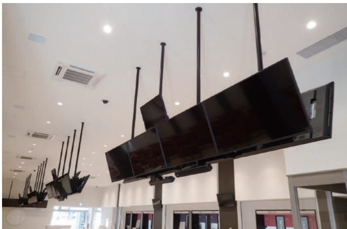
某商業施設 横マルチ天吊り
